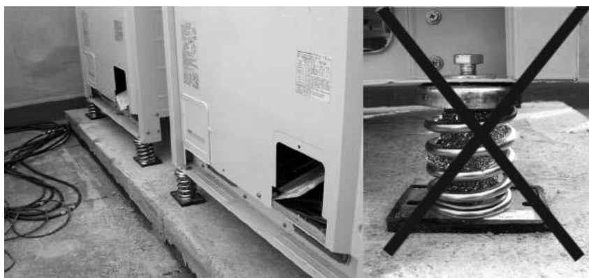
شکل ۵. نصب نادرست یونیت‌های خارجی روی پایه‌های فنری
